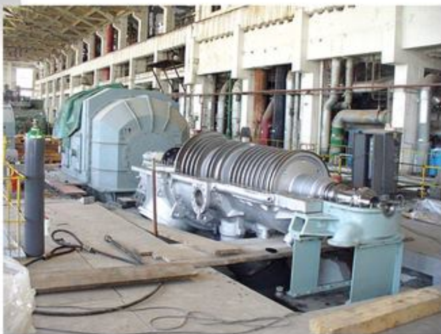
В процес е монтирането на нова турбина в ТЦЦ София, която ще заработи до края на годината
